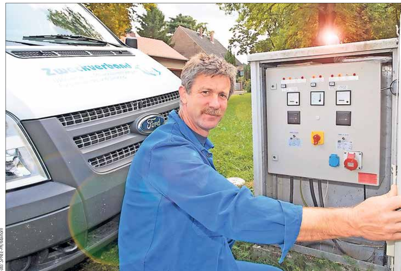
Rote Lampe und mittlerer Zeiger melden: Abwasser staut sich im Pumpwerk. ZVWA-Mitarbeiter Detlef Jänicke muss die Ursache finden.
