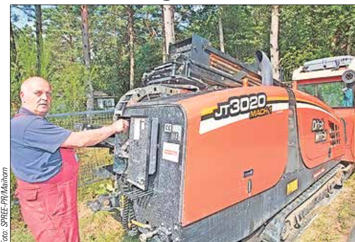
Die Kollegen der BTB Brück Bohrtechnik GmbH dirigieren das Gerät zum gesteuerten Horizontalvortrieb in Hartmannsdorf.
