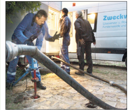
Hier wird die Luft nicht angehalten, sondern eingeleitet – computer-gesteuerte Druckblasen bringen wassersparenden Spüleffekt.
