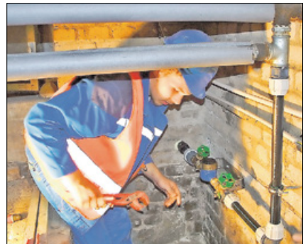
Empfehlenswert: Hausanschluss und Teile der Installation erneuern!
