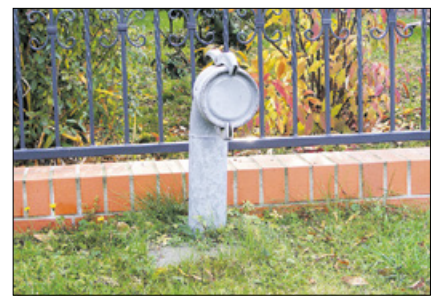
Für Entsorger wie für Grundstückseigentümer von großem Vorteil ist ein Ansaugstutzen zur Straße hin. Zusätzliche Schlauchlängen sind nicht mehr nötig und kein LKW muss mehr aufs Grundstück fahren.
