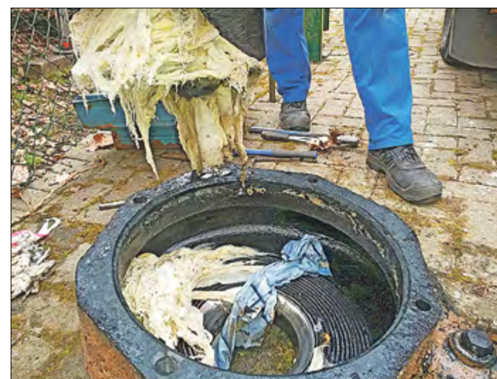
Verstopfte Pumpen sorgen für Ärger und höhere Kosten. Foto: FWA
