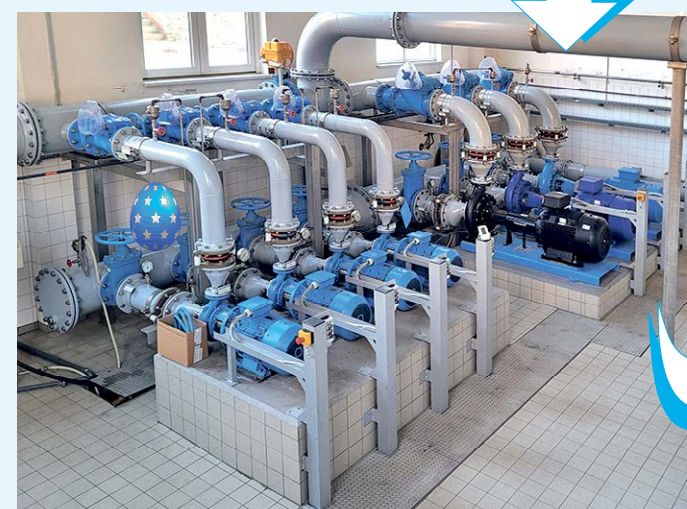
Im WW Fürstenwalde leiten Pumpen das Wasser in den Hochbehälter.
